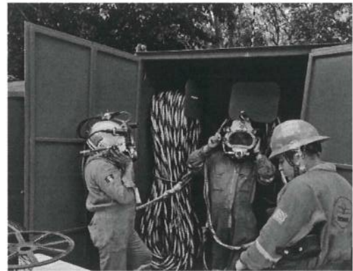
Descripción: Prueba de comunicación de cascos y cabina de control
